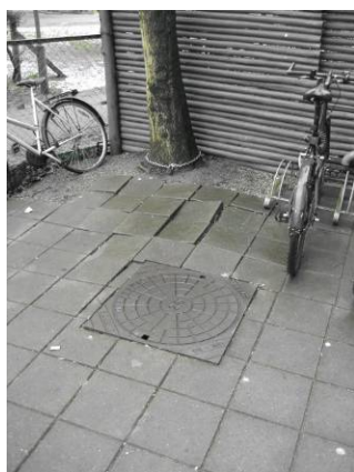
Ujævn belægning ved Hillerødgade 25
