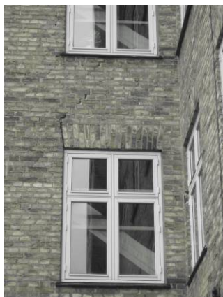
Sætningsrevne i brystning.
