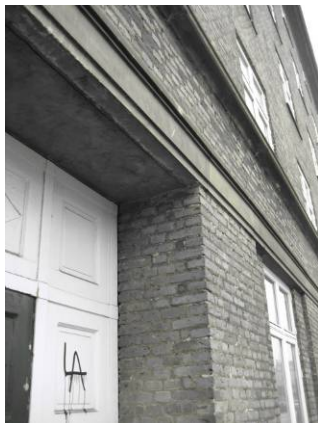
Revnedannelser i puds ved bærejern over port.
