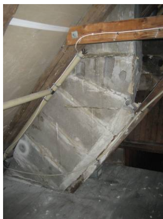
Uhensigtsmæssig gennembrydning af ventilationskanaler.
