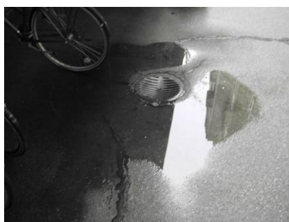
Lunke i belægning ved afløbsrist i gård.
