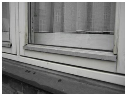
Forvitret træværk i vindue.
